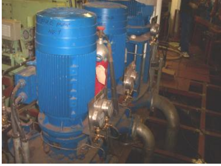
Resim 2.2: Normal yangın pompası
