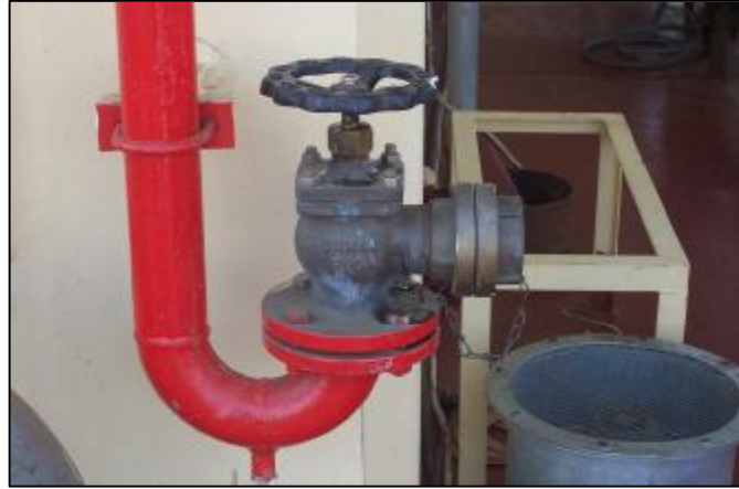
Resim 2.1: Yangın tesisatı valf bağlantısı
