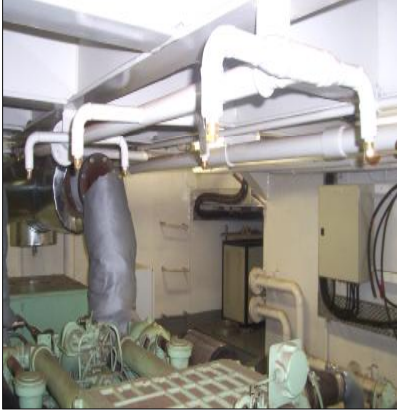
Resim 2.6: Makine dairesi yangın bağlantısı
