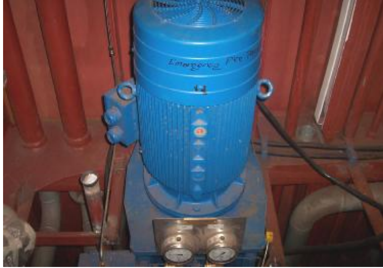
Resim 2.3: Acil durum pompası
